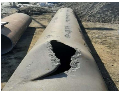
شکل ۲- پارگی خط لوله
