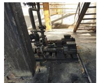
آثار سوختگی تاسیسات ناشی از آتش سوزی
