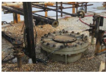
شکل ۴- فلنج محل نصب پمپ عمودی
