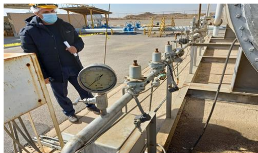
سیستم کنترل هیتر حادثه دیده
