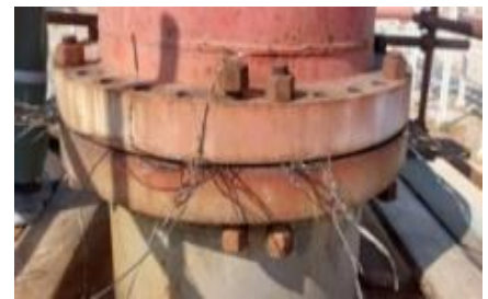
تخریب گسکت فلنج
