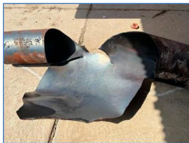
شکل ۲- پارگی خط لوله
