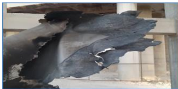
نمایی از پارگی خط لوله
